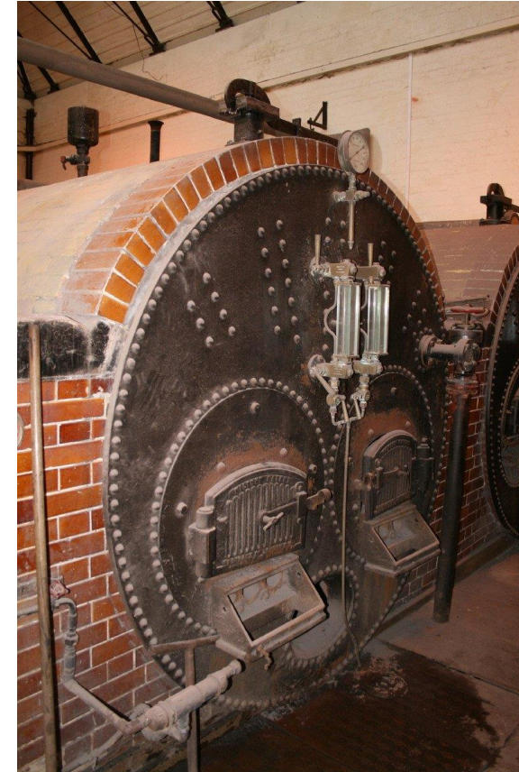
Abb. 1: historischer Kessel eines Fernwärmesystems [1]
