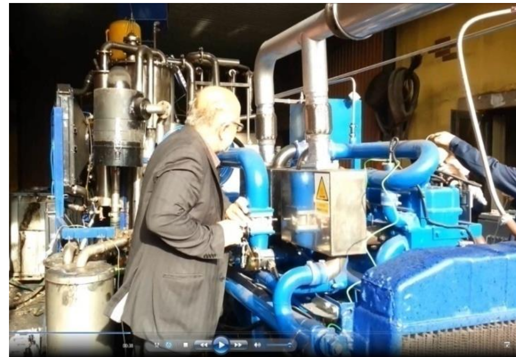
Rys 5. Jednostka CHP z układem zgazowania. Źródło: A.Cenian, IMP PAN
