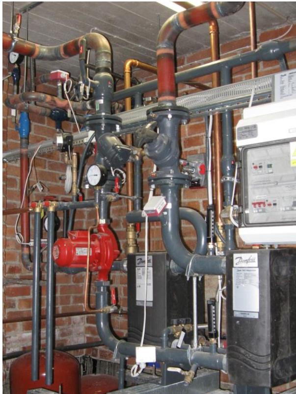
Abb.2: Übergabestation eines Gebäudes an die Fernwärme. Quelle: Thermopolis [1]
