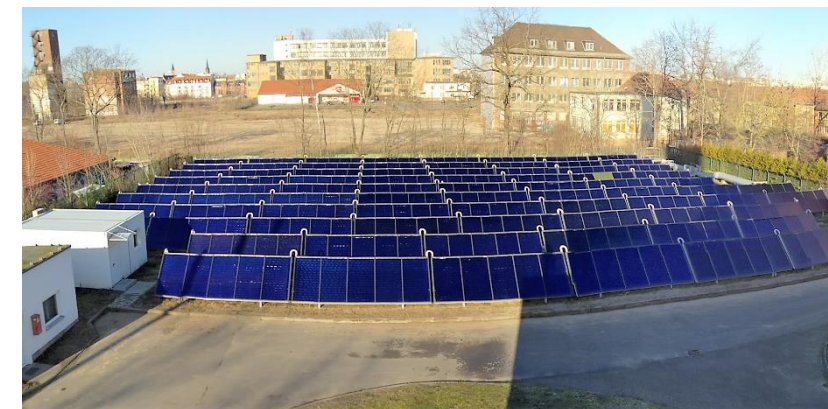
Abb. 4: Solaranlage auf dem Boden [4]
