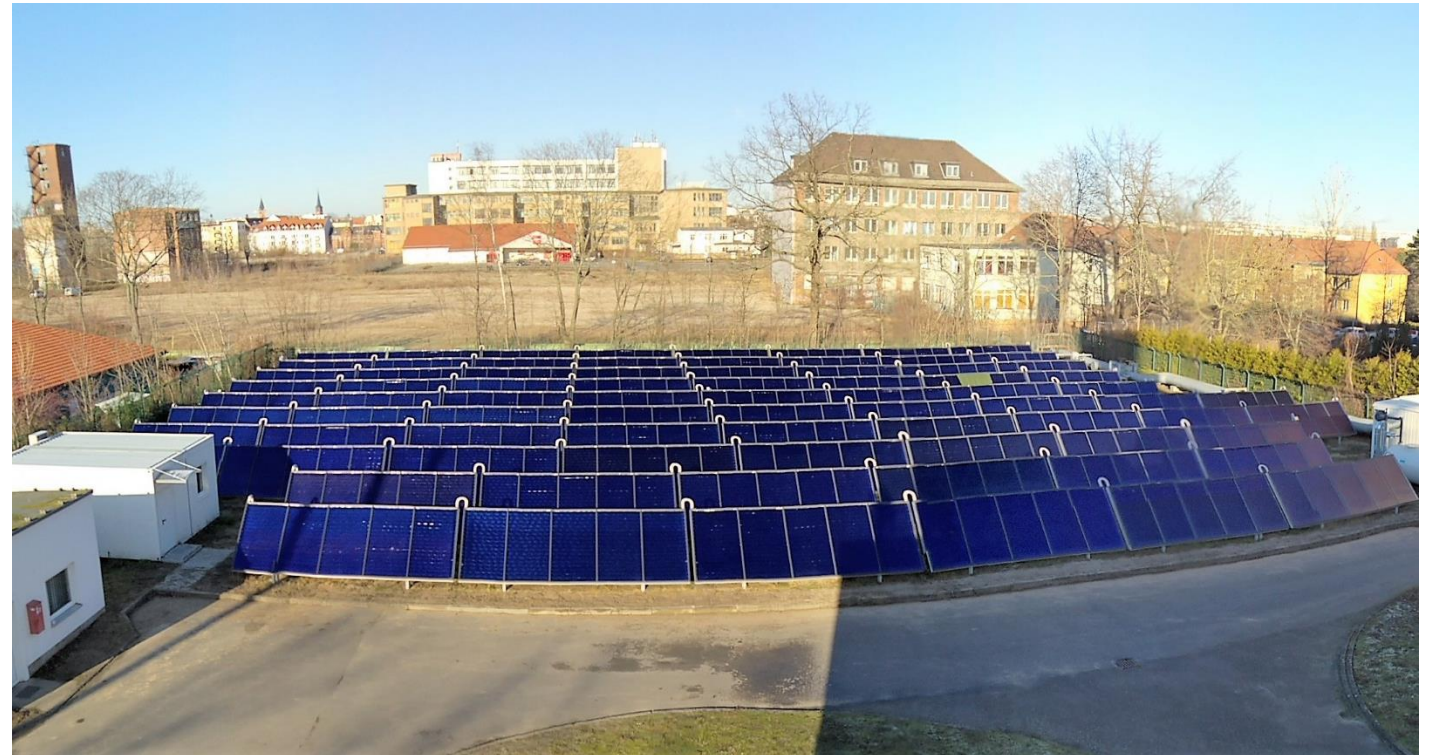
Abb. 6: auf dem Boden aufgestellte Flachkollektoren, Foto Simonides [4]
