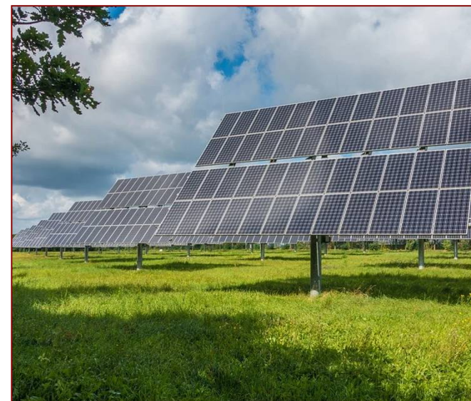
Rys. 4.: Kolektory słoneczne. Źródło: mrganso [3]
