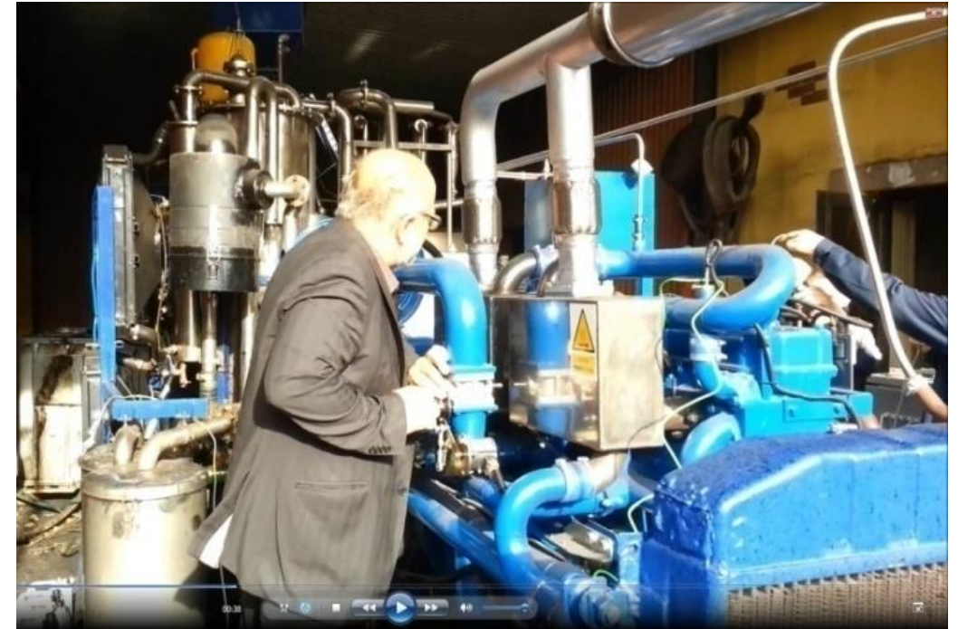
Abb.: 5. 50 kW KWK-Anlage; Quelle: A.Cenian, IMP PAN
