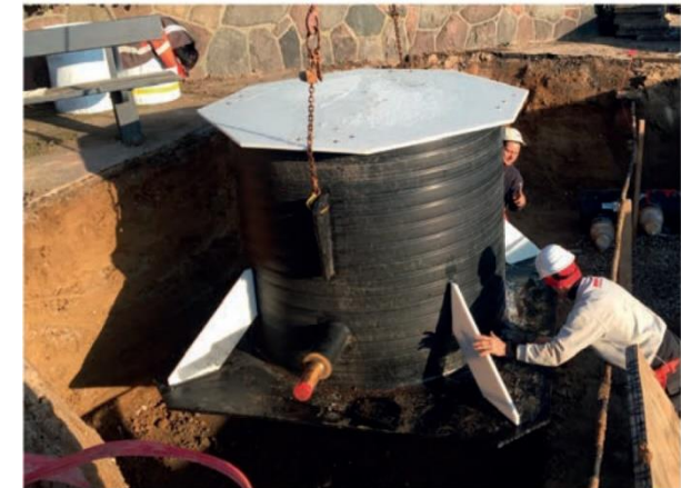
Abbildung 15: Implementierung einer Niedertemperatur-Gitterzone im Raum Kopenhagen. Quelle: Grundfos [13]
