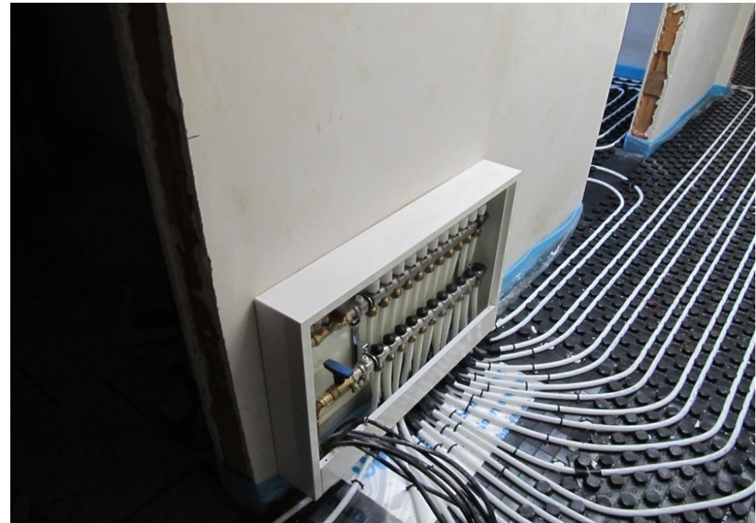
Abbildung 6: Fußbodenheizung-Heizkreis-Verteiler. Quelle: ZEBAU GmbH [5]
