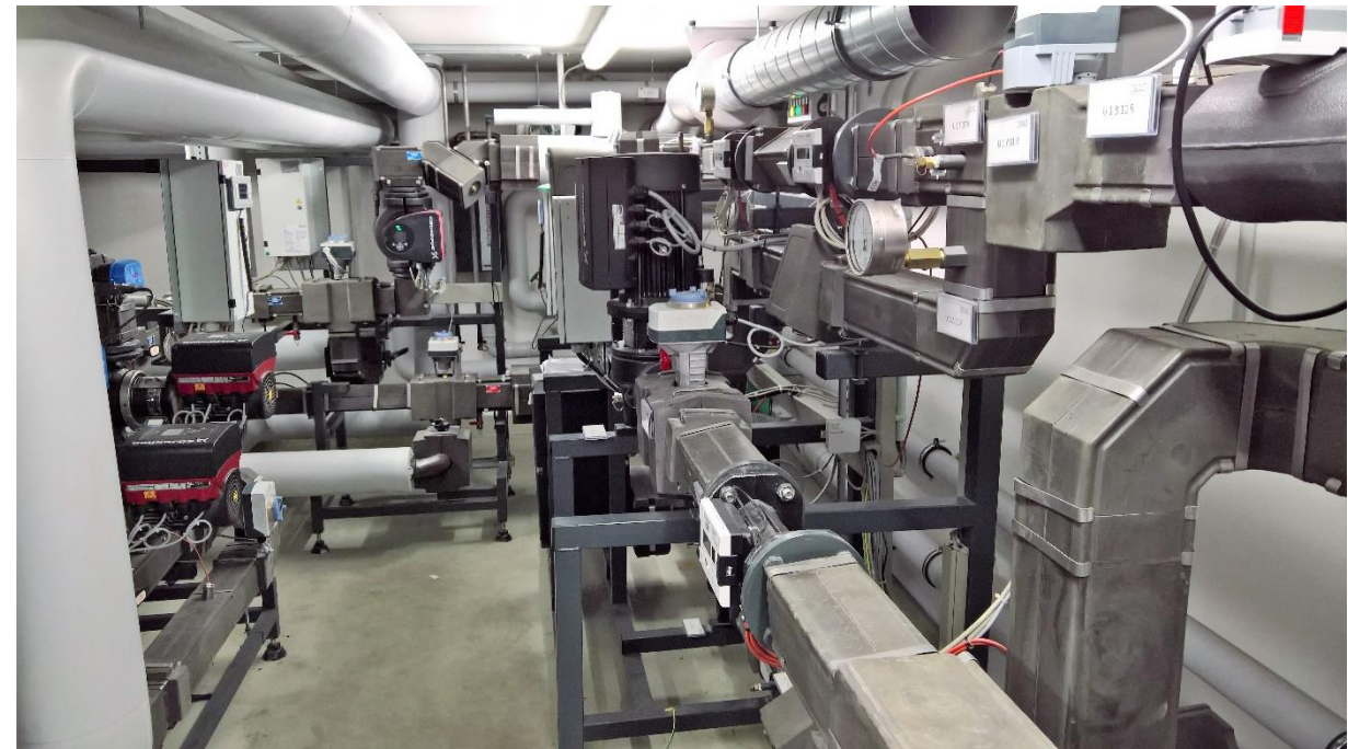
Abbildung 12: Der Heizungsknoten im Keller. Quelle: S. Simonides [7]
