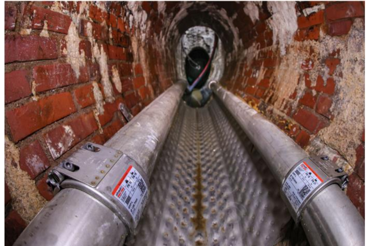
Abbildung 21: Wärmetauscher in der Kanalisation. Quelle: FRANK [11]
