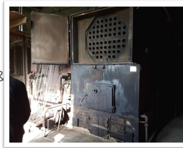
Abb. 20: Heizkessel, eigenes Foto: V. Kirsanovs [6]
