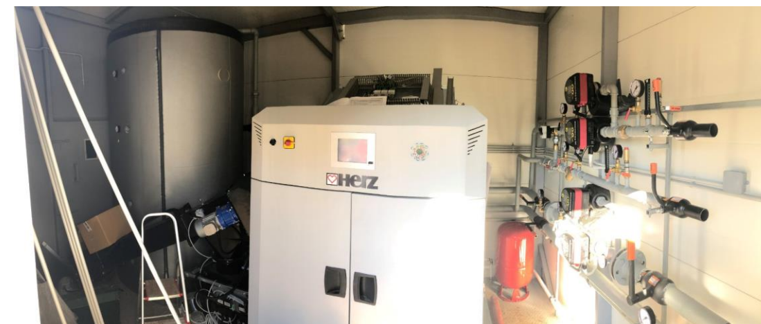
Abb.23: moderner Holzpelletkessel , eigenes Foto: V. Kirsanovs [6]
