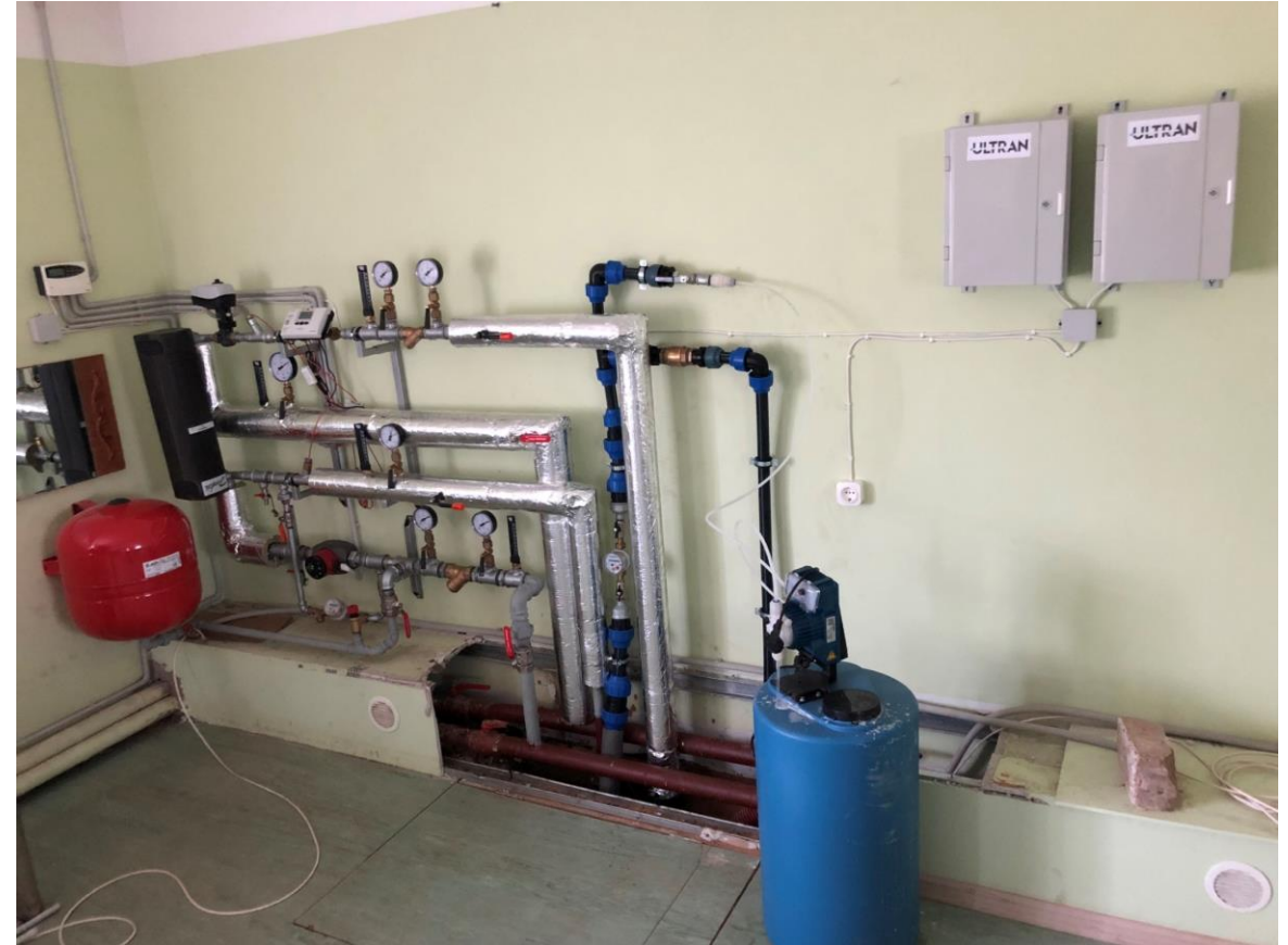
Abb. 23: Fernwärmeübergabestation in einem öffentlichen Gebäude , eigenes Foto: V. Kirsanovs [6]
