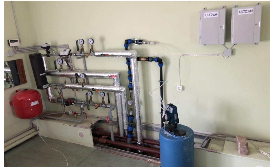
Abb. 5: Hausanschlussstation NT-Nahwärmenetz, Foto Sandis Kalniņš [8]
