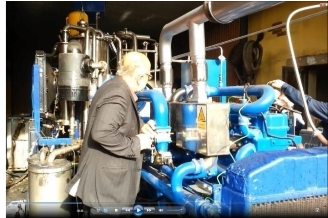
ТЭЦ на 50 кВт
