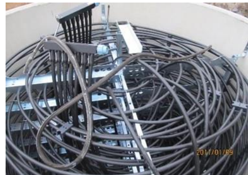
2 pav. Tuščia saulės ledo saugykla su šilumos mainų vamzdynu, šaltinis: ZEBAU GmbH [2]
