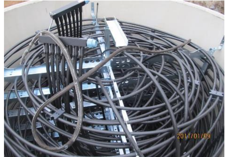
Kuva 5: Jäävarastoyksikön putkisto. Lähde: ZEBAU GmbH [5]
