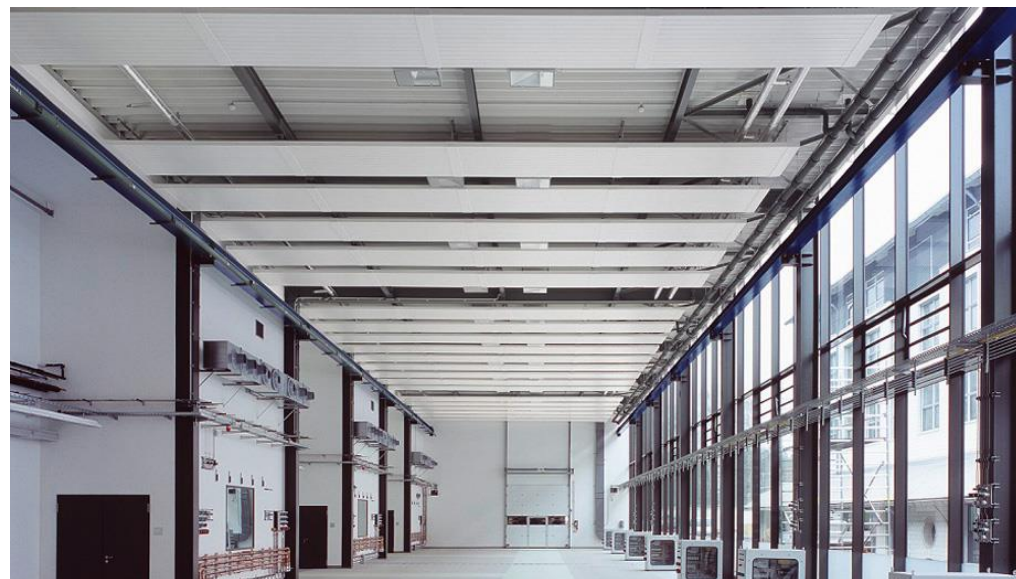
Kuva 15: kattolämmityselementtejä hallissa, lähde: Frenger UK
