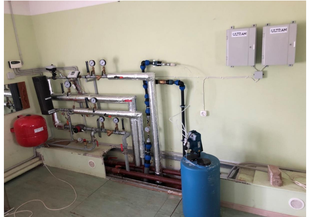
Kuva 23: Julkisen rakennuksen lämmönjakokeskus ja lämmönsiirtojärjestelmä. Lähde: Gulbenen kunta [6].
