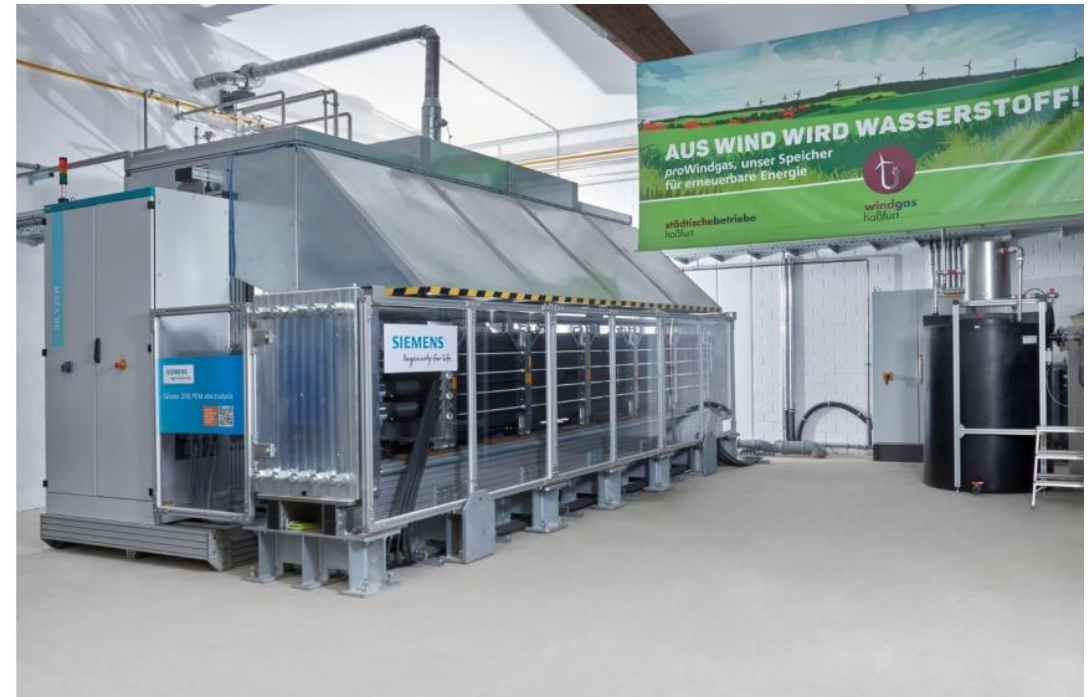
Siemensin Silyzer 200 (teho 1,25 MW) elektrolysaattoria käytetään Stadwerk Haßfurtissa tuottamaan vetyä uusiutuvaa energiaa tuottavien laitosten ylijäämäsähköllä. Kuvan lähde: Stadwerk Haßfurt GmbH
