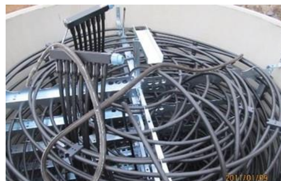
Rys. 2: Magazyn i wymiennik ciepła. Źródło: ZEBAU GmbH [2]
