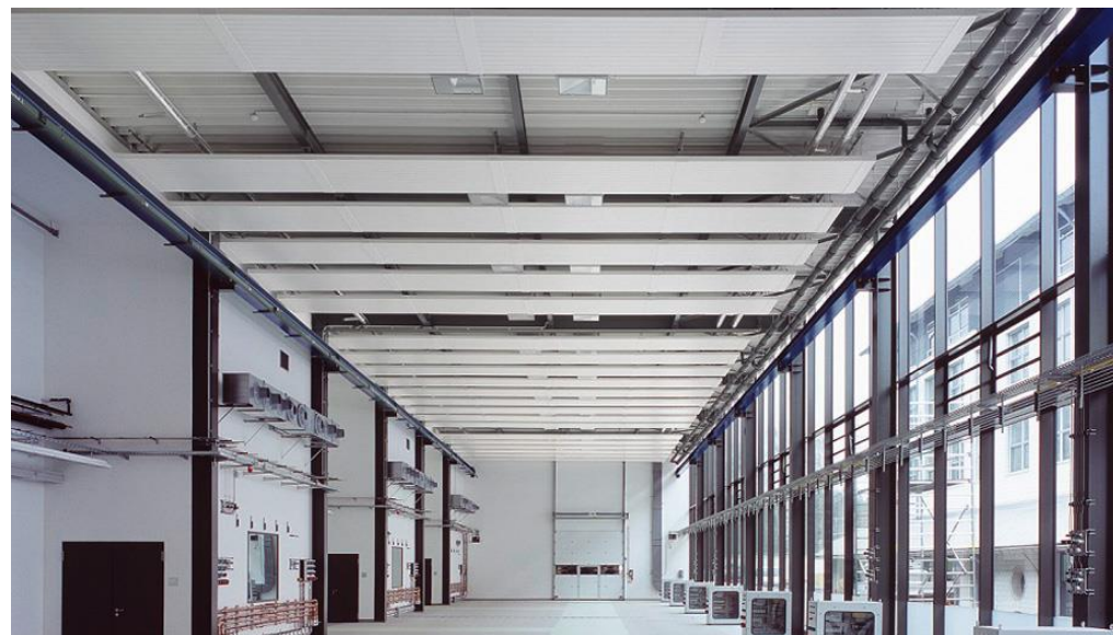
Rys 15: Sufitowe płyty grzewcze w hali, źródło: Frenger UK
