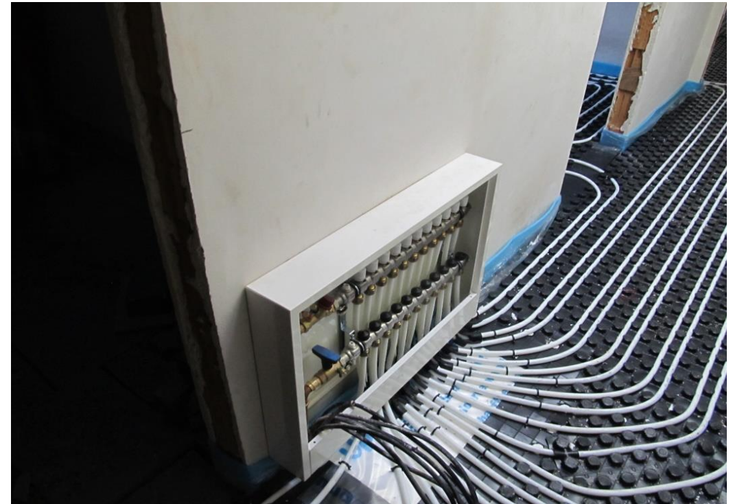
Rys 6: Rozdzielacz ogrzewania podłogowego, źródło: © ZEBAU GmbH
