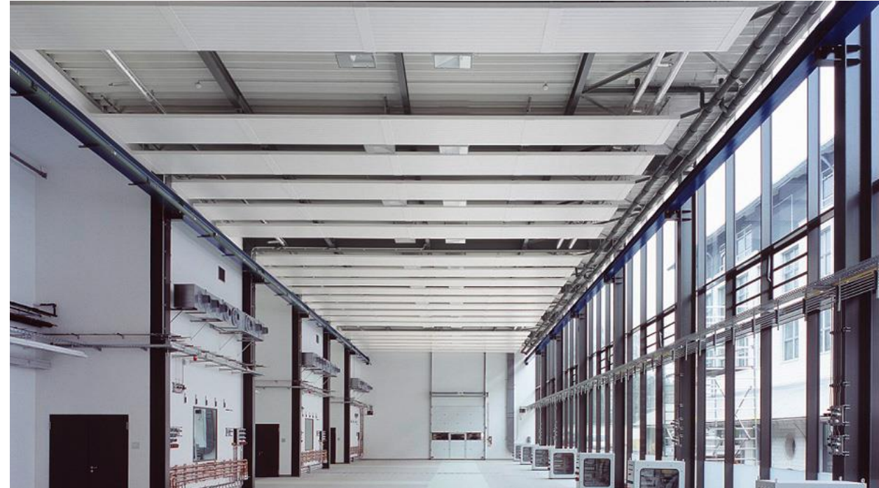
Рис 12 потолочные нагревательные панели в холле, source: Frenger UK
