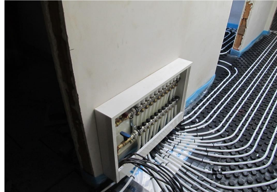
Рис 6: Распределитель контура теплого пола, источник: © ZEBAU GmbH
