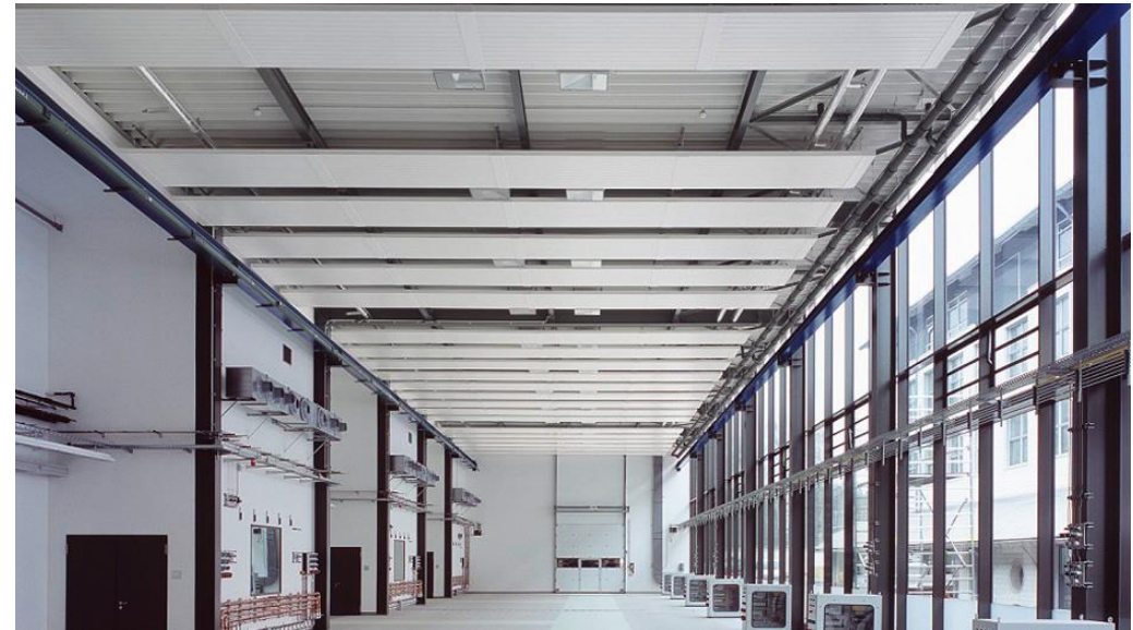
15 pav.: šildančios lubų plokštės salėje, šaltinis: Frenger UK [12]
