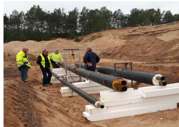
Figur 5 – Udlånt af HalmstadsEnergi och Miljö AB
